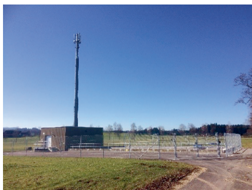
Neue Pumpstation mit zwei Regenbecken
